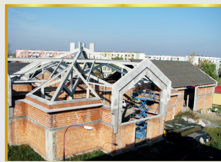
2013 rok - dach pokryty w części papą
